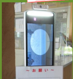
自動検温器設置
